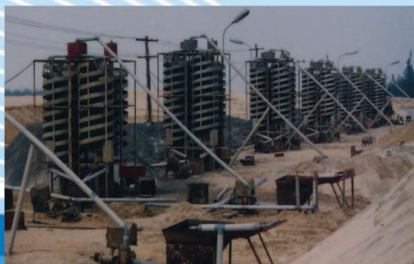
Hệ thống tuyển vát đúng do Viện nghiên cứu, chế tạo và lắp đặt tại Bình Định (năm 2013)
